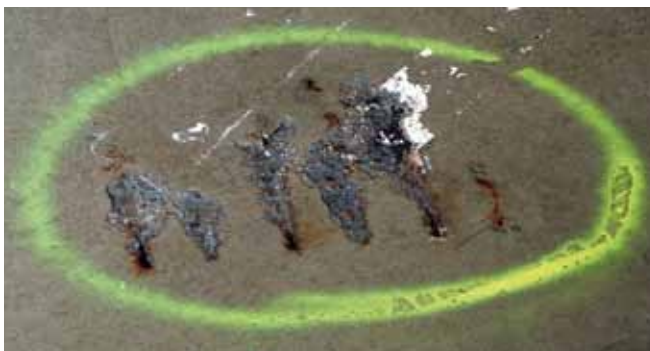
Die häufigsten Schäden an Verkehrsbauwerken treten durch chloridinduzierte Bewehrungskorrosion auf – ausgelöst durch Tausalze. Hier schafft der Kathodische Korrosionsschutz (KKS) Abhilfe: Ebenso wie die Korrosion selbst basiert KKS auf elektrochemischen Reaktionen.
