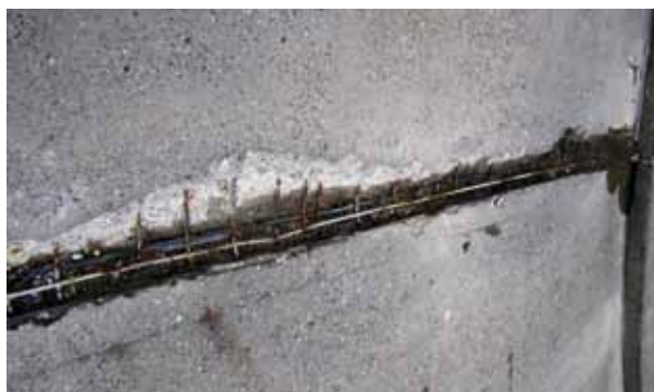
Tückisch: Der Erweiterungsbau von 1982 wies erhebliche witterungs- und alterungsbedingte Schäden auf.
